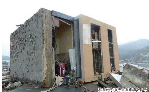
スライド2 転倒した3階建RC建物
