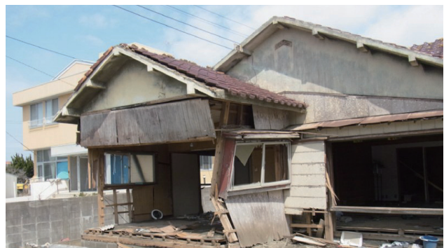
スライド3 津波で柱が折れた住宅
