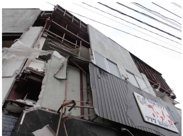
スライド11 鉄骨建物の外壁の剥落
