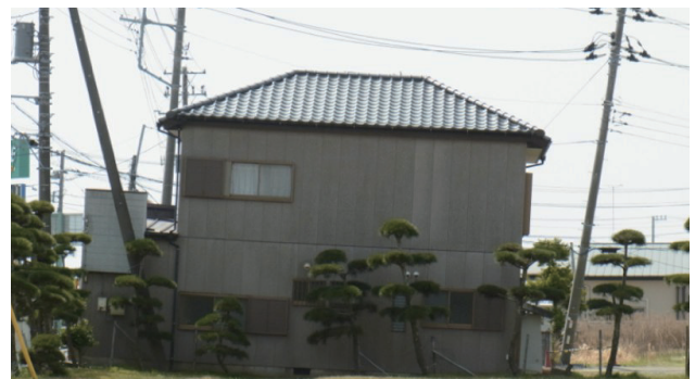
スライド5 地盤の液状化で傾いた住宅
