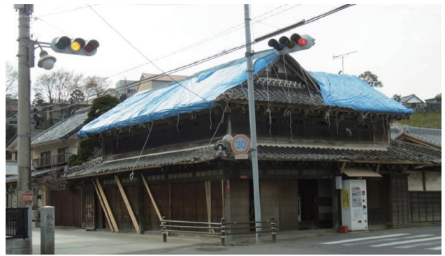
スライド8 屋根瓦が損傷した伝統木造住宅
