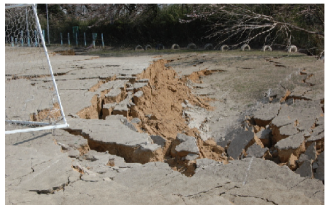
スライド6 小学校校庭の地盤崩壊
