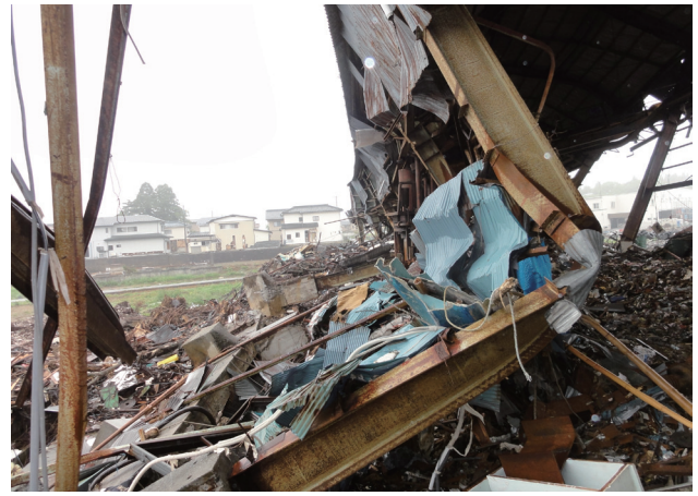
スライド4 津波で柱が折れた鉄骨の工場
