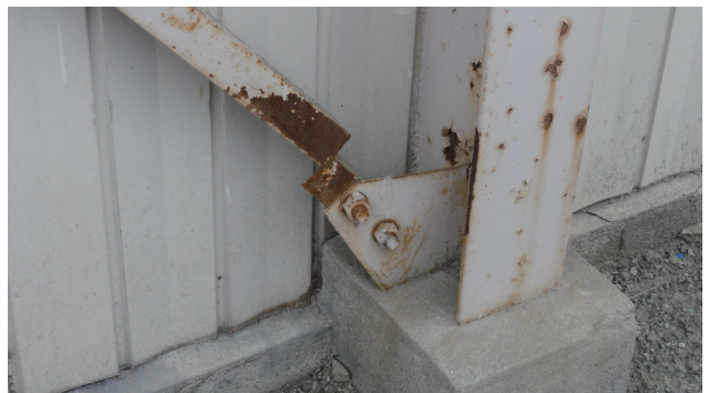
スライド10 破断した鉄骨の筋かい
