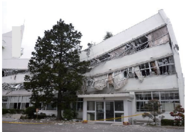
スライド9 層崩壊した大学校舎
