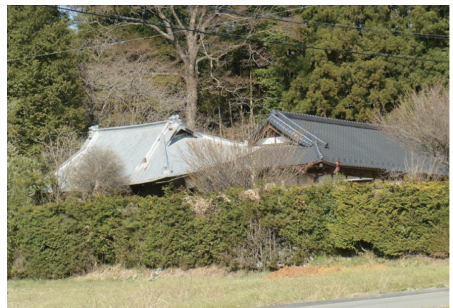
スライド7 地盤崩壊で大きく傾斜した住宅
